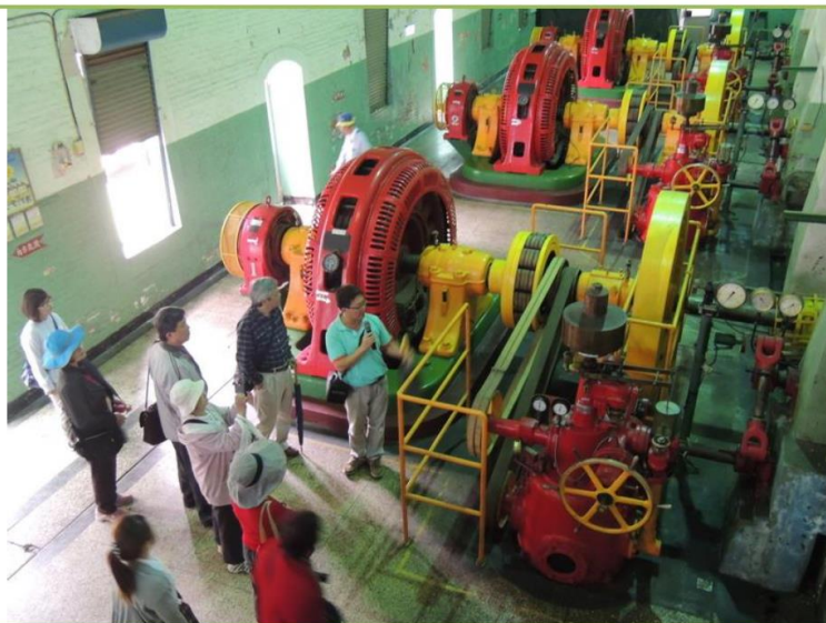
說明：古董級的發電設備(二)
